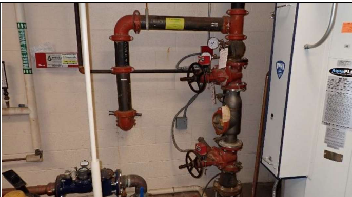
Fire sprinkler riser
